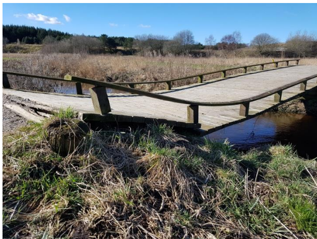
Broen på hul 12 er skredet på fundamentet og i gang med at blive repareret
